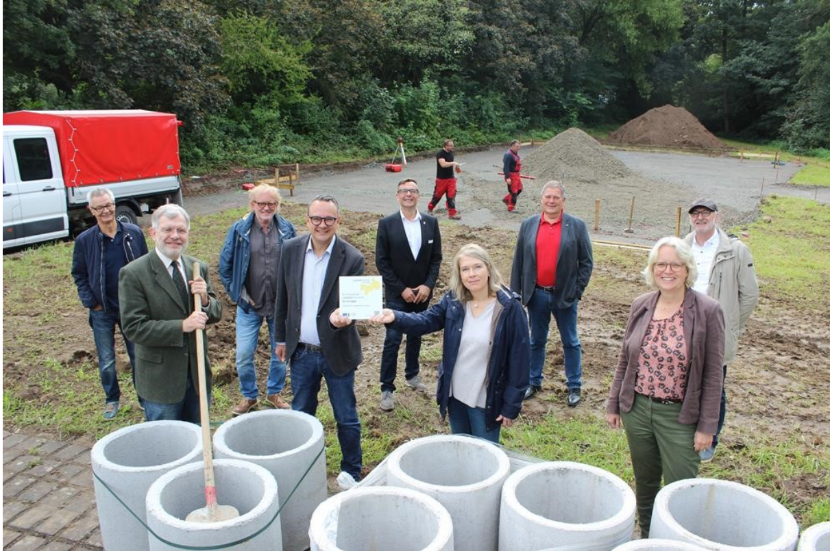
Viele Gäste an der Baustelle: Fritz Steinke ("einfach Lemgo"), Bürgermeister Dr. Reiner Austermann, Wolfgang Sieweke ("Bürger für Lemgo"), Bauamtsleiter Markus Baier, Jugendamtsleiter Thomas Portong, Leader-Regionalmanagerin Susanne Weishaupt, Udo Golabeck ("Soziales Lemgo"), Dr. Katharina Kleine Vennekate ("Grüne") und Claus Cieciera (CDU, von links). (Foto: Marlen Grote)
